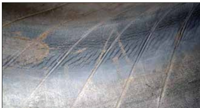
EFFET : Marbrage du revêtement intérieur – plissement CAUSE : Sous-gonflage
