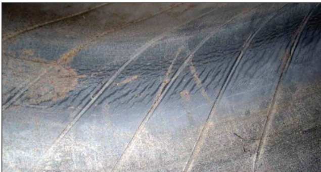
EFFET : Marbrure du revêtement intérieur – plissement CAUSE : Sous-gonflage
