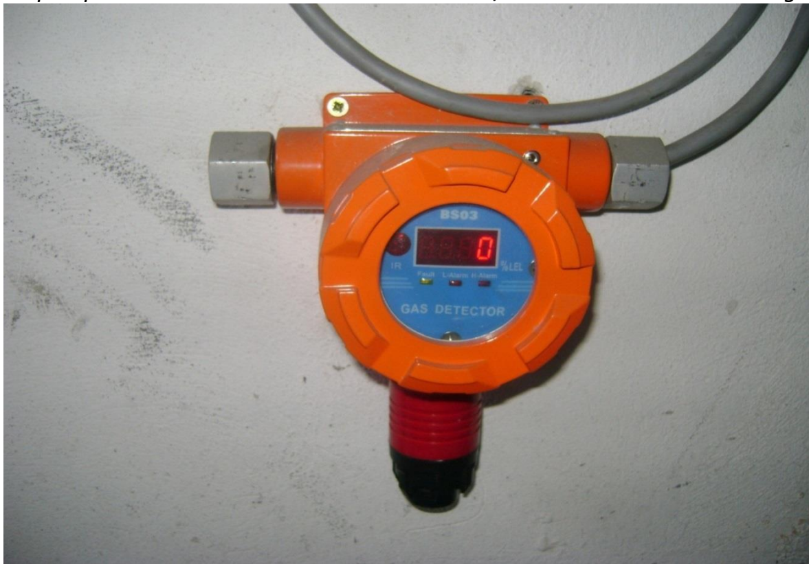
Statie pompe distributie solvent EXXSOL™ DSP 100/160 –detector solvent- imagine 1
